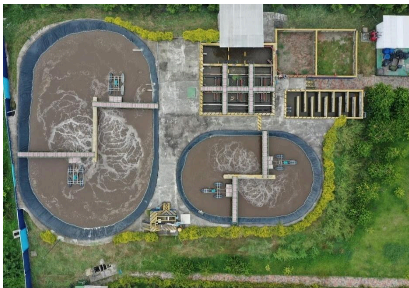
Foto 7.6. Planta de tratamiento de aguas residuales.
